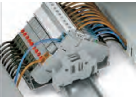
Клеммы для датчиков. Подвод питания со стороны шкафа управления.
