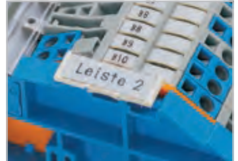
Групповая маркировка на N-шинопроводе в качестве оконечного стопора
