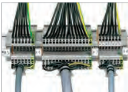
Установка кабеля в распределительную коробку. Кабель устанавливается с подключенными розетками и вставляется прямо в базовые клеммы.
