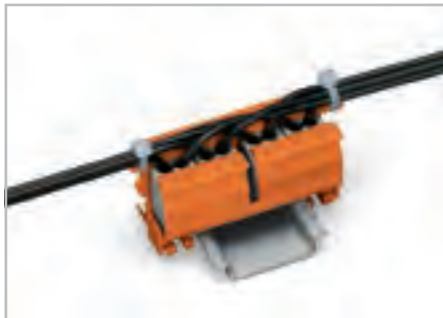
Фиксация кабельной стяжкой на держателе, перпендикулярно направлению прокладки кабеля. Зажимы, маркированные опрессовкой.
