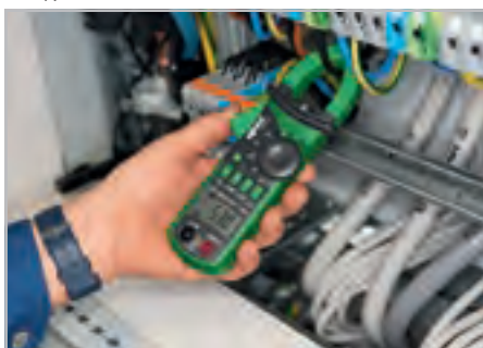
Измерения тока в распределительном шкафу
